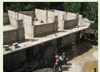
Neubau der Oberstufe in Meyer. Im Erdgeschoss findet bereits der Unterricht für drei Klassen statt.
