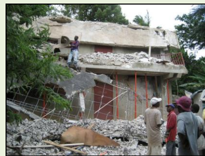
Ein Teil des zerstörten Schulgebäudes nach dem Erdbeeben
