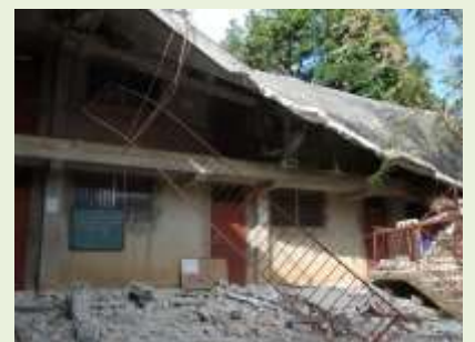
Das Schulgebäude nach dem Erdbeben. Wie durch ein Wunder wurde damals niemand verletzt.
